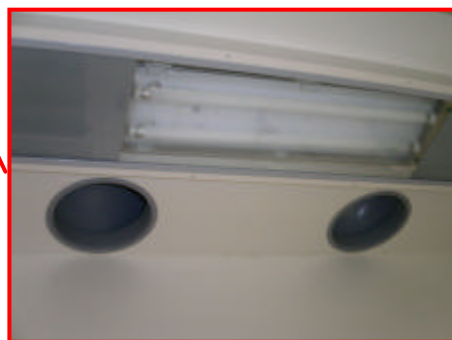
I condotti da 200 mm per l'estrazione dell'aria (nascosti sotto al cielo della cappa)
